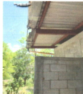
CANALES Y BAJADAS DE AGUA PLUVIAL, SUSTITUCION CANALES EN MAL ESTADO
